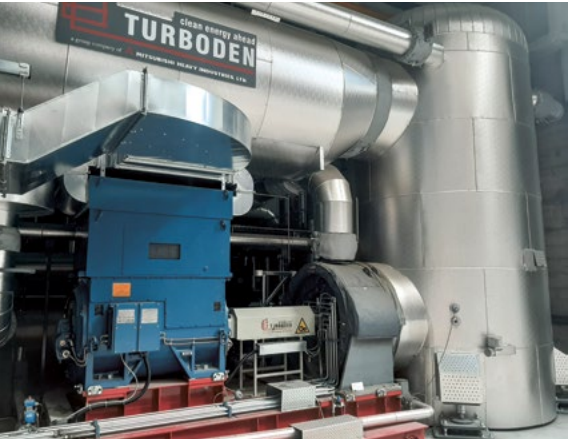
Installation de récupération de chaleur à Éclépens.
