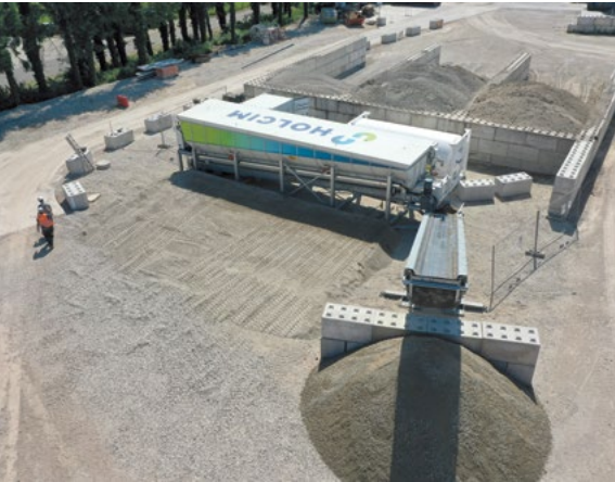
Grâce à cette installation mobile, basée sur la technologie neustark, nous stockons durablement chaque année environ 500 tonnes de CO 2 dans des granulats de béton.
