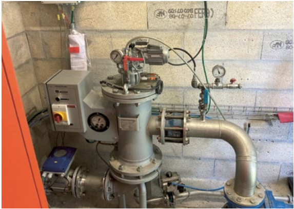
Grâce à une nouvelle pompe, nous avons augmenté le volume d'eau recyclé à Éclépens.
